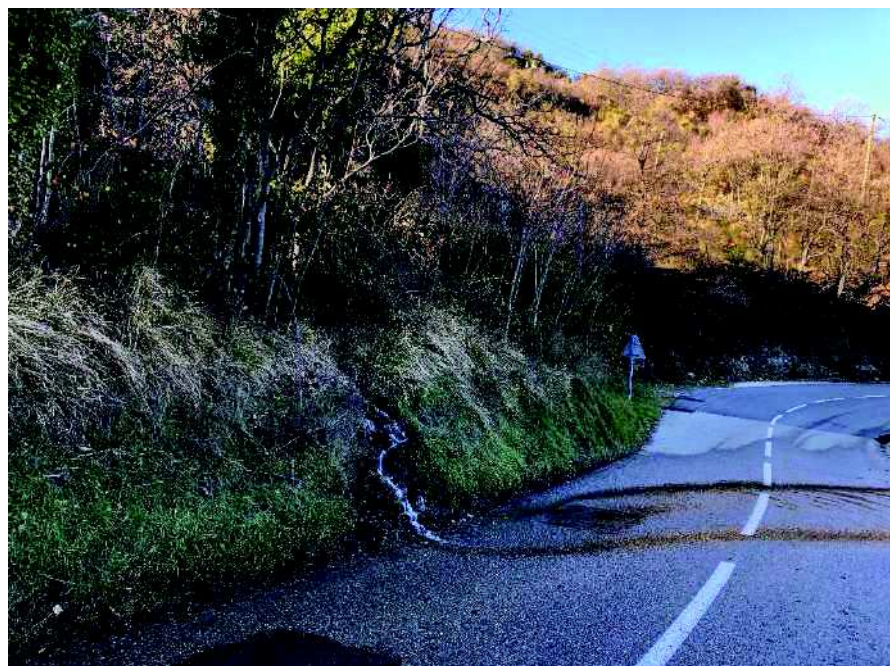
Photo n° 42 : venue d'eau sur la D8 au pied du lotissement du Colombier – zone E - Photo du 25 janvier 2021
