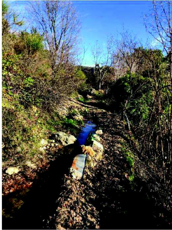
Photo n°40 : état du canal d'irrigation dans le quartier des Ranchières Canal bouché par un glissement - Photo du 25 janvier 2021
