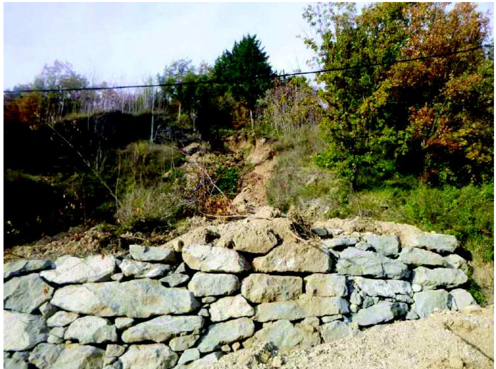
Photo n°80 : ravinement au-dessus des enrochements bordant la D8 en aval du village - Photo 30 novembre 2019
