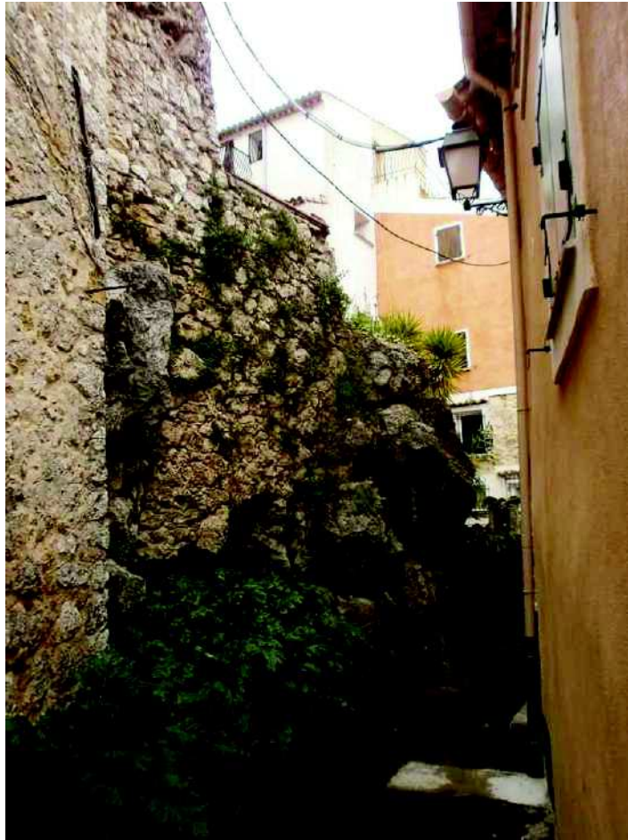
Photo n°74 : mur dont la base est en partie effondrée construit sur des blocs instables - en partie sud-est du village
