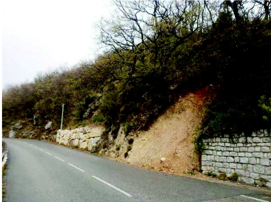
Photo n°53 : loupe de glissement en bordure de la D8 à la sortie du village vers Bezaudun - Photo du 10 avril 2019
