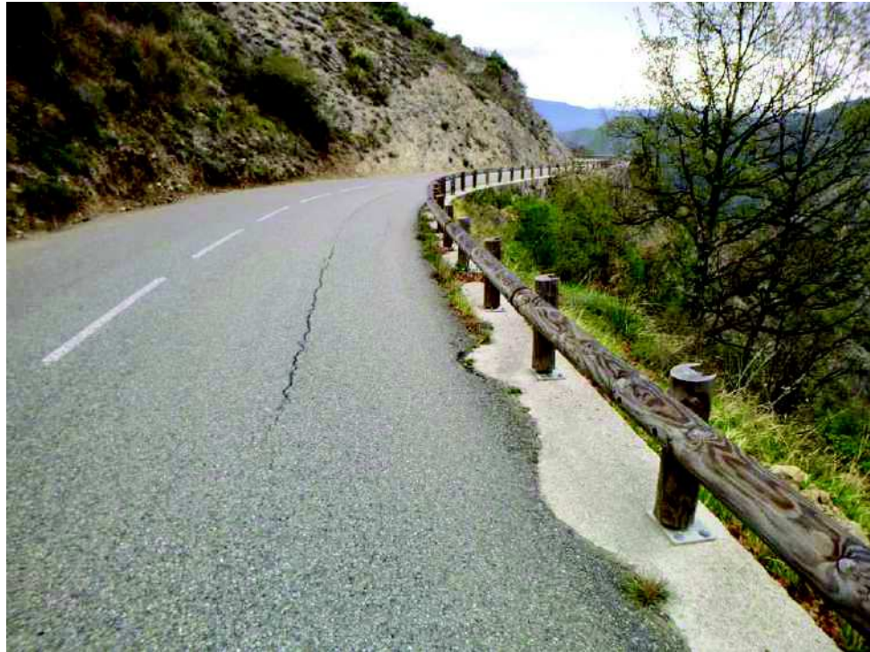
Photo n°55 : affaissement de la bordure aval de la D8 en direction de l'usine des Eaux – Photo du 10 avril 2019
