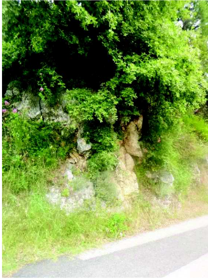
Photo n°77 : blocs instables au-dessus de la D1 à la sortie du village en direction des Ferres – Photo du 10 juin 2019
