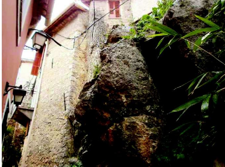
Photo n°72 : bloc détaché en bordure sud-est du village Photo du 10 avril 2019
