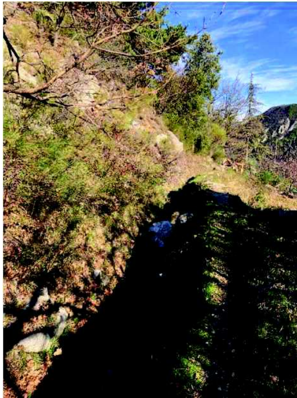
Photo n° 41 : état du canal d'irrigation dans le quartier des Ranchières Canal bouché par un bloc - Photo du 25 janvier 2021
