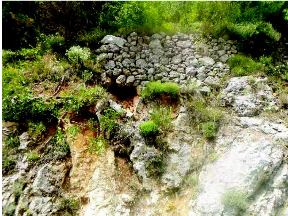
Photo n°78 : vestiges de chutes de blocs au-dessus de la D1 en direction des Ferres – Photo du 10 juin 2019
