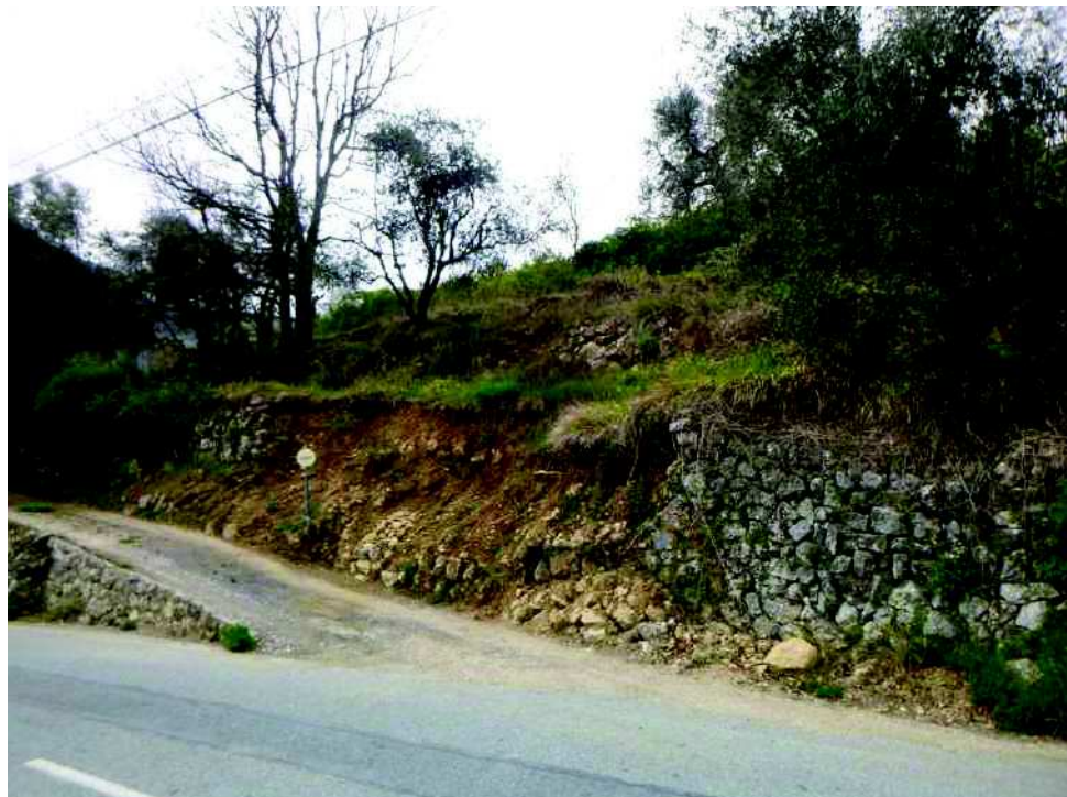
Photo n°52 : effondrements de murets d'anciennes banquettes agricoles – Quartier de l'Aiguillète – Photo du 10 avril 2019
