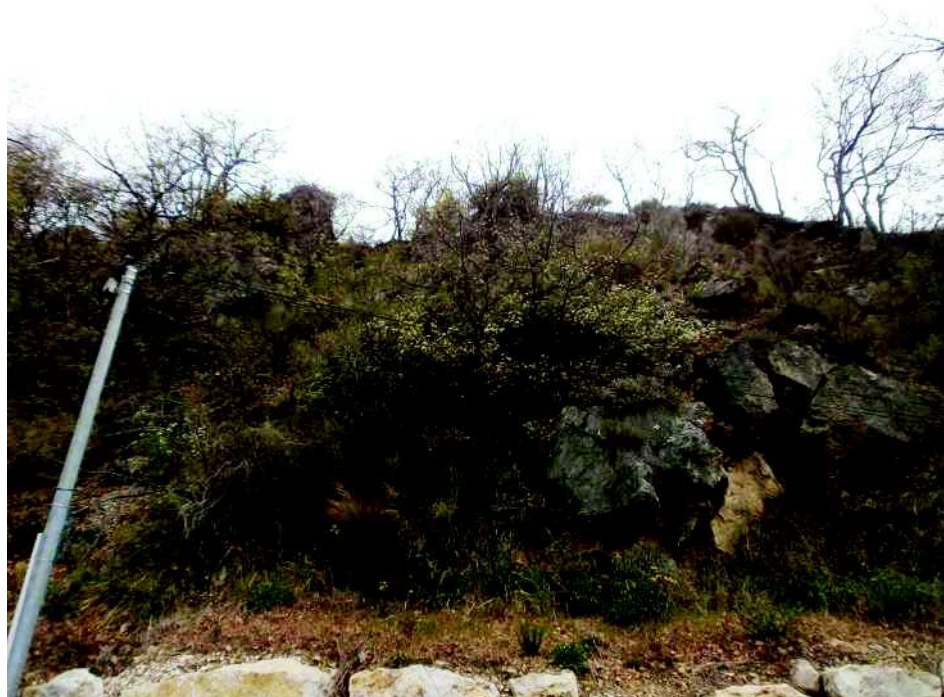
Photo n°79 : blocs instables en bordure de la D8 à la sortie du village vers Bezaudun - Photo du 10 avril 2019
