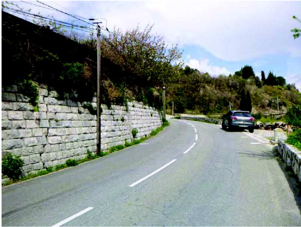
Photo n°95 : mur de soutènement en pierres fissuré – Quartier des Moulins Photo du 10 avril 2019
