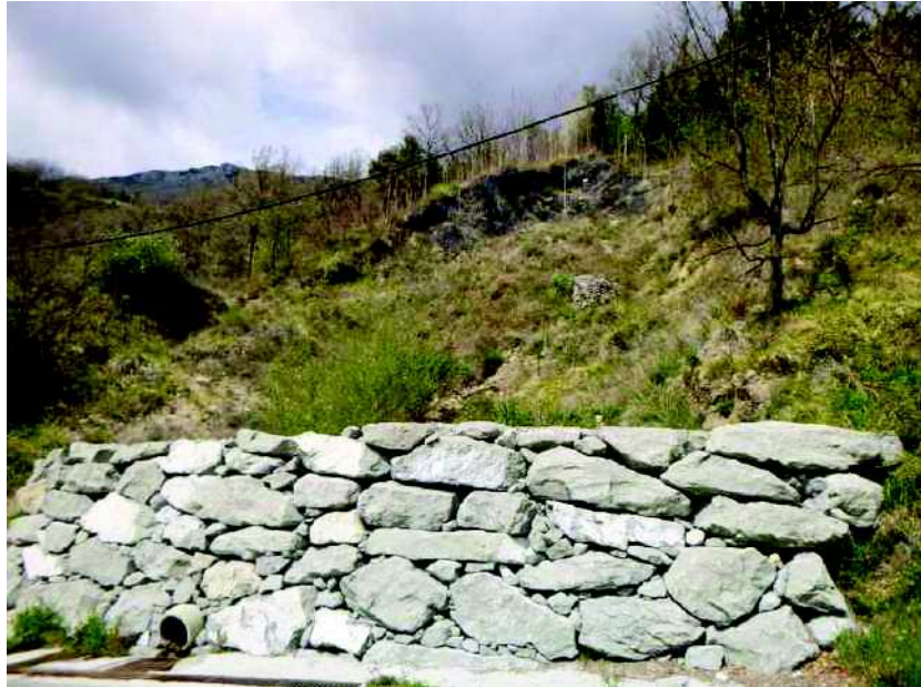
Photo n°34 : glissement soutenu par des enrochements au quartier des Moulins. Photo 12/04/19
