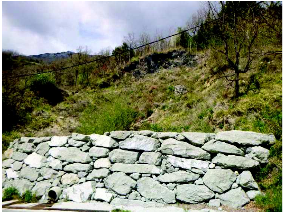
Photo n°10 : sortie d'eau du versant au pied des enrochements bordant la D1 en montant vers le village – Photo du 10 avril 2019
