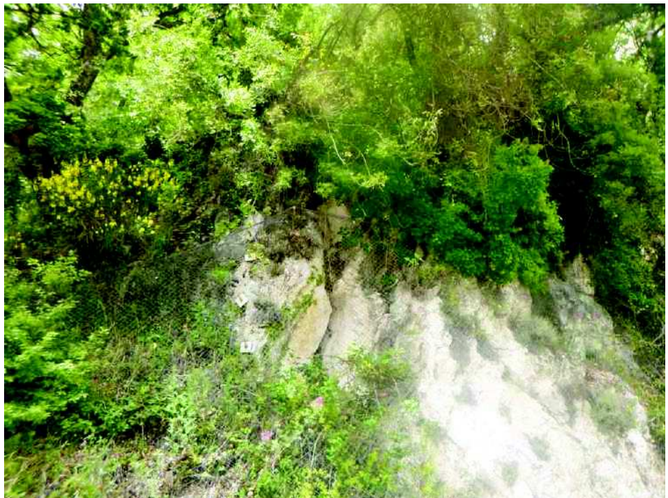
Photo n°93 : protection grillagée et bloc cloué le long de la D1 au nord du village de Bouyon
