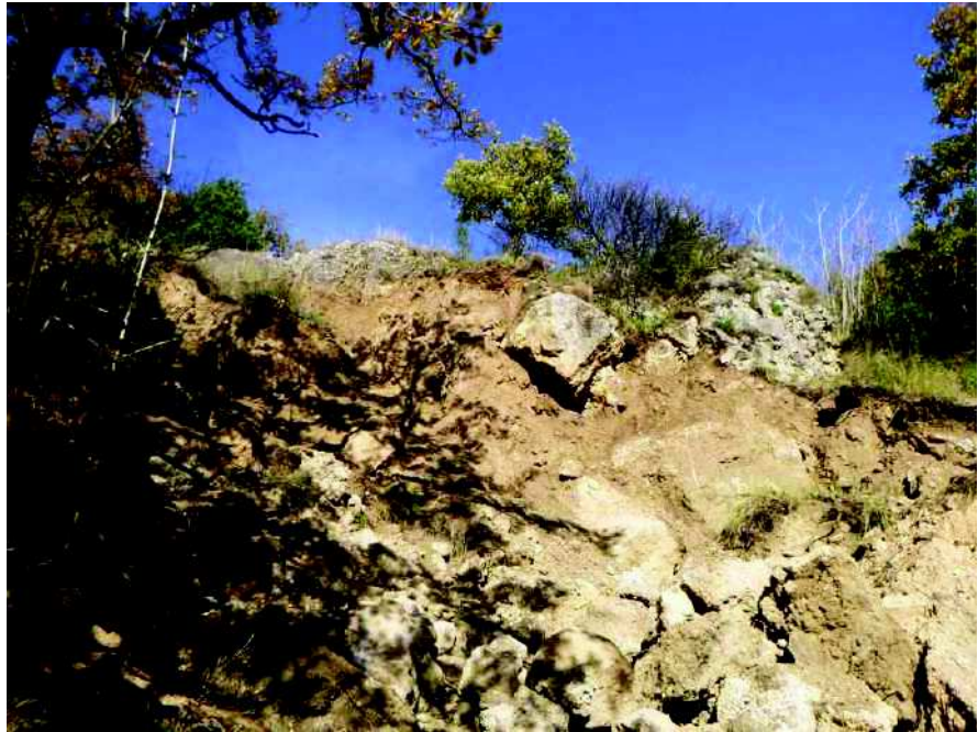
Photo n°33 : exemple de blocs inclus dans les éboulis de versant pouvant être remis en mouvement brutalement à la suite d'un glissement de terrain
