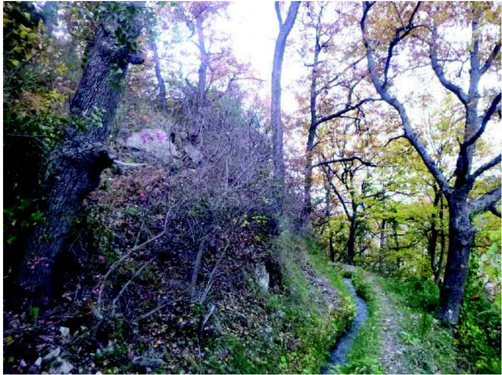
Photo n°64 : bloc « B19 » en position instable au-dessus du canal des Moulins - Photo du 30 novembre 2019
