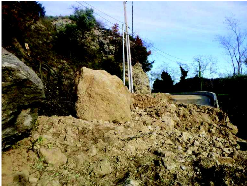
Photo n° 46 : vue du pied du glissement survenu le 24 novembre 2019 Route départementale D1 coupée
