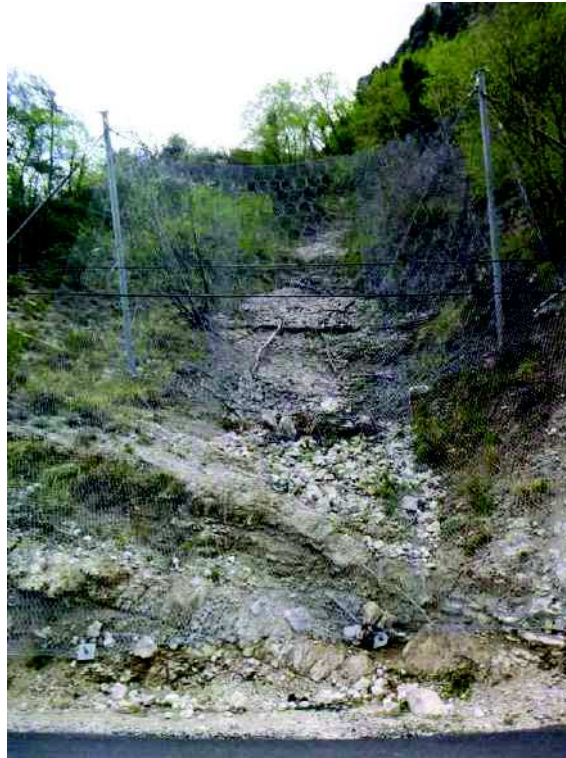
Photo n°91 : écran pare blocs le long de la D1 Quartier la Mouchonnière – Photo du 10 avril 2019
