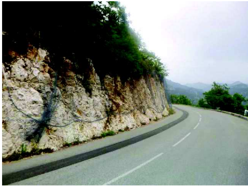
Photo n°92 : protection grillagée le long de la D1 au nord du village de Bouyon
