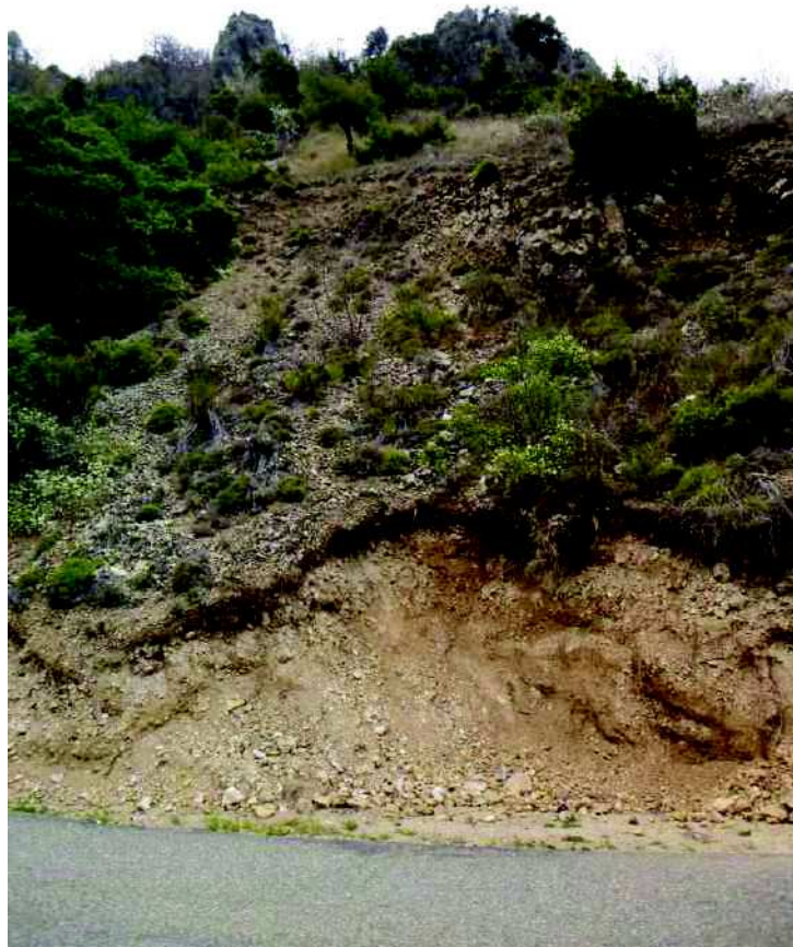
Photo n°54 : loupe de glissement de talus dans les éboulis en bordure amont de la D8 au sud-ouest du village – Photo du 10 avril 2019
