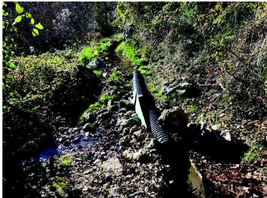
Photo n° 39 : état du canal d'irrigation dans le quartier des Ranchières Fuite vers l'aval - Photo du 25 janvier 2021
