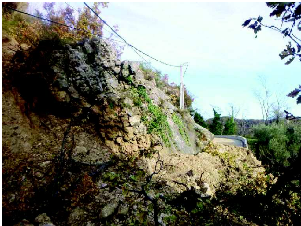
Photo n° 47 : vue du pied du glissement survenu le 24 novembre 2019 Amas bréchiques déstabilisés
